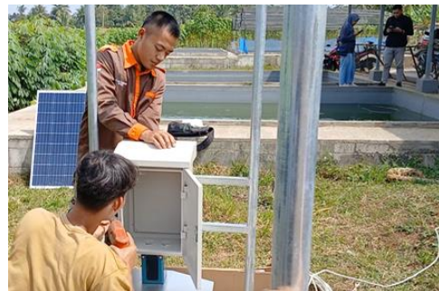
Gambar 2. Instalasi Teknologi IoT & Energi Terbarukan
