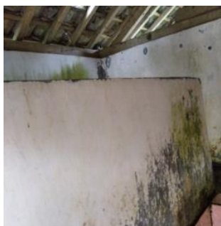
Gambar 6: toilet belum terpisah bangunannya dan terbuka
